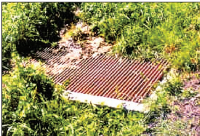
Rejilla separadora de sólidos
